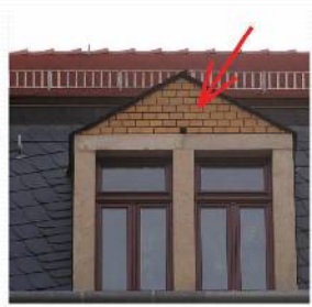
Integrative Artenschutzmaßnahme im Gaubendreieck – eingebauter Kasten für Mauersegler und Haussperlinge, Helgolandstraße
