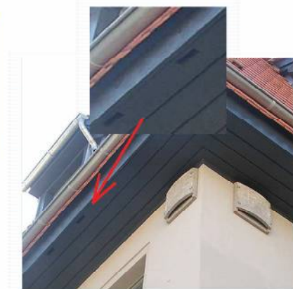
Fledermausflachkästen und integrierte Artenschutzmaßnahmen für Mauersegler und Haussperlinge durch Aussparungen im Holzgesimskasten, Rißweg
