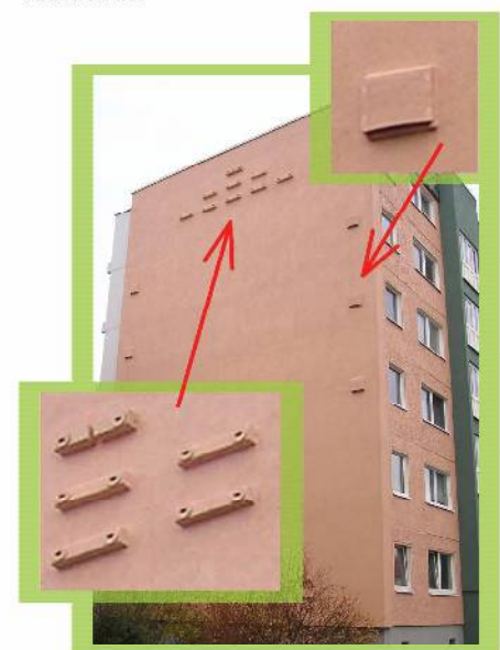
Mauersegler- und Haussperlingskästen sowie Fledermausflachkästen am Giebel eines WBS 70, Bulgakowstraße
