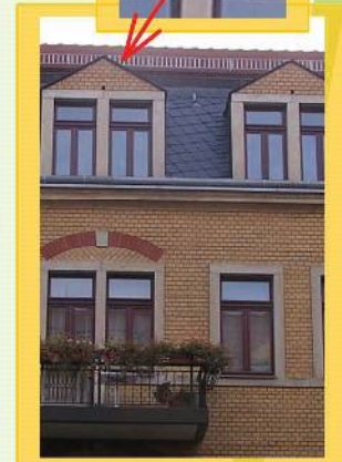
Integrative Artenschutzmaßnahme im Gaubendreieck - eingebauter Kasten für Mauersegler und Haussperlinge, Helgolandstraße
